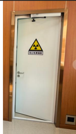
照片6 操作门、闭门装置
